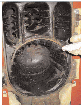
Facultatif : pré-nettoyage chimique du corps de chauffe.
